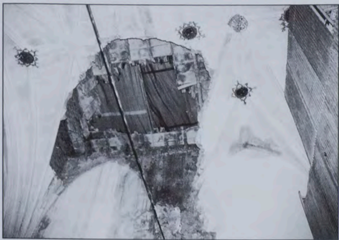
DERRUMBAMIENTO DE UNOS PLEMENTOS DE LA BÓVEDA DE LA CAPILLA DE SAN NICOLÁS, EN SAN JUAN DE ORTEGA, BURGOS
