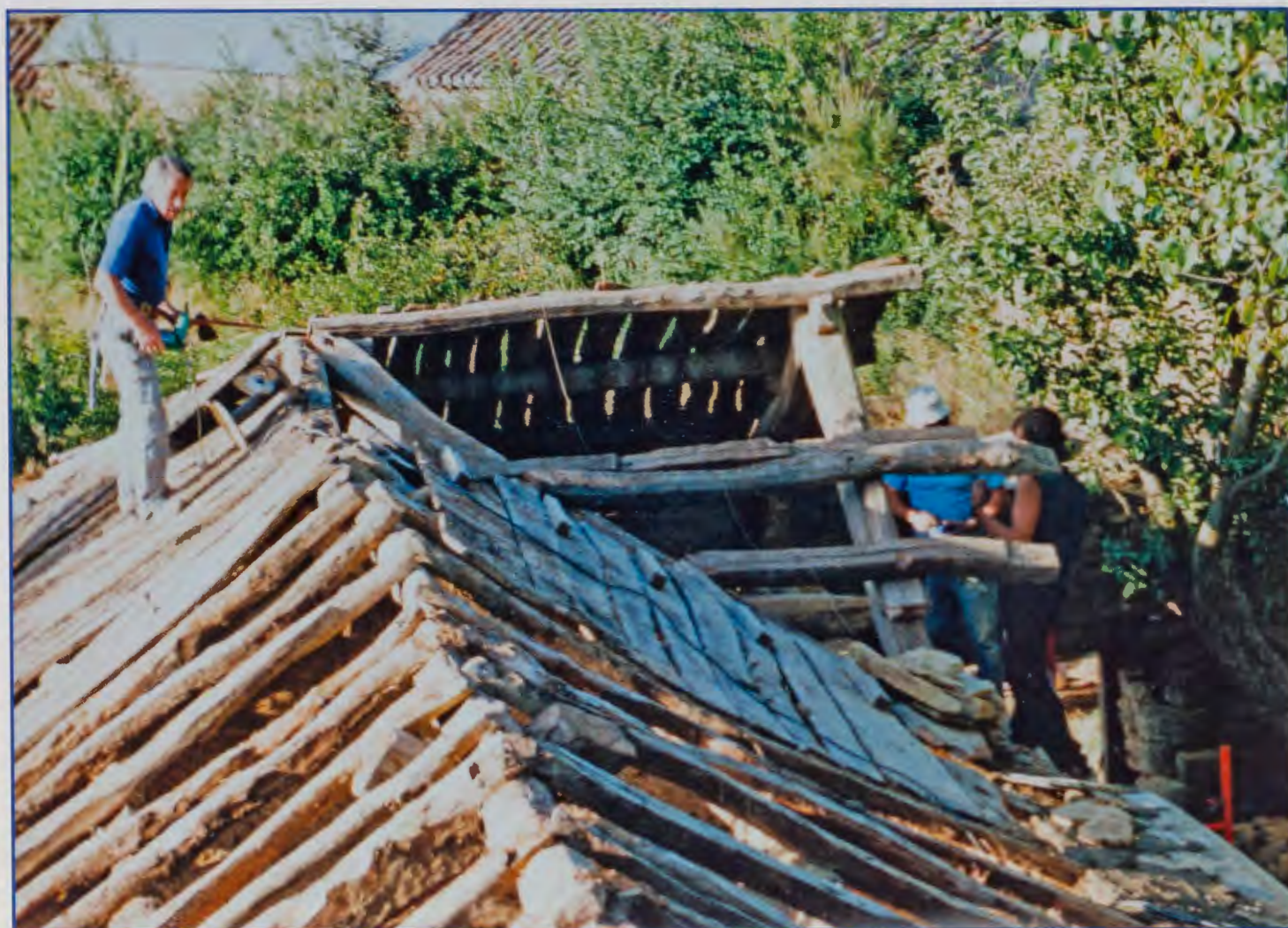
Ken Thomas, Armando y Víctor reparan el techo de la granja, septiembre 1992 / ...repair the barn roof, September 1992
