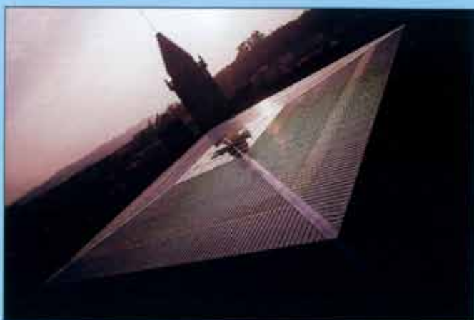
Vista de la cubierta metálica creada para las excavaciones del Claustro (1991-92). Foto: G. Gil
