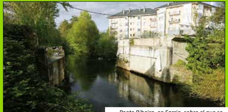
Ponte Ribeira, en Sarria, sobre el que se han comenzado las obras de restauración
