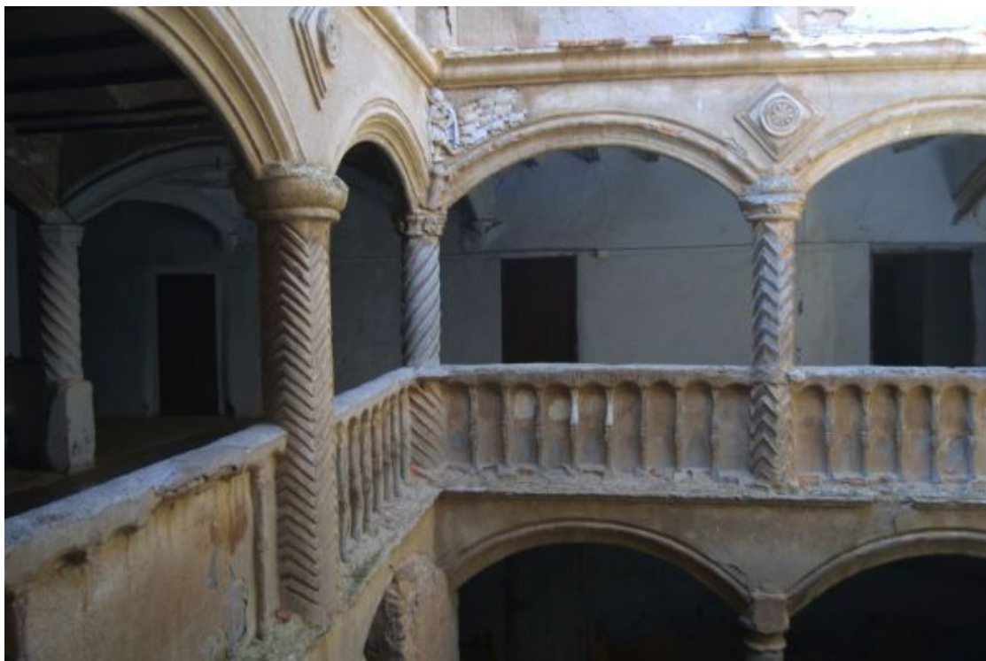
Estado actual del antiguo e importante hospital de Torrelapaja.
