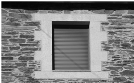
Substitución desafortunada da carpintería de madeira por unha ventá de PVC que incorpora unha persiana do mesmo material. As pezas de granito que enmarca o oco son tamén novas e resultan incongruentes, tanto por non se corresponder cas características construtivas da zona como polo seu acabado serrado
