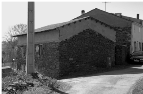
Construción de muros de cachotería de lousa ampliados en altura con fábrica de ladrillo sen revestir
