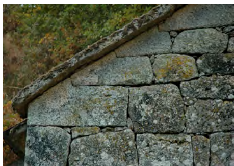
Detalle da fábrica de granito do muro piñón dunha edificación tradicional no concello de Cea, Ourense
