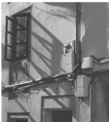
Cables e caixas fixadas á fachada dunha vivenda urbana
