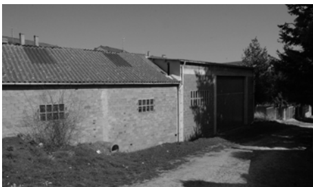
Construción con cerramentos de ladrillo oco, non previsto para quedar sen revestir
