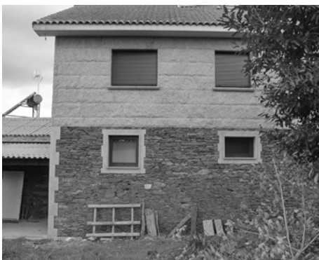
Incongruencia na utilización de perpiaño de granito xunto a unha fábrica de cachotería de lousa
