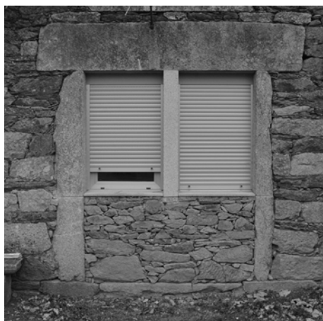
Modificación desafortunada dun oco para formar dúas ventás con carpintería e persianas de aluminio anodizado
