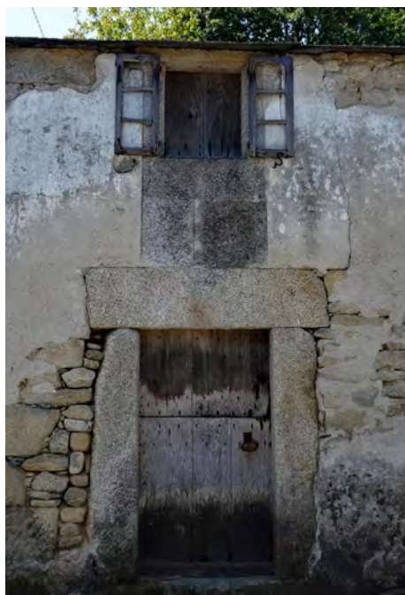
Porta de entrada a unha casa dividida en dous corpos para permitir a ventilación
