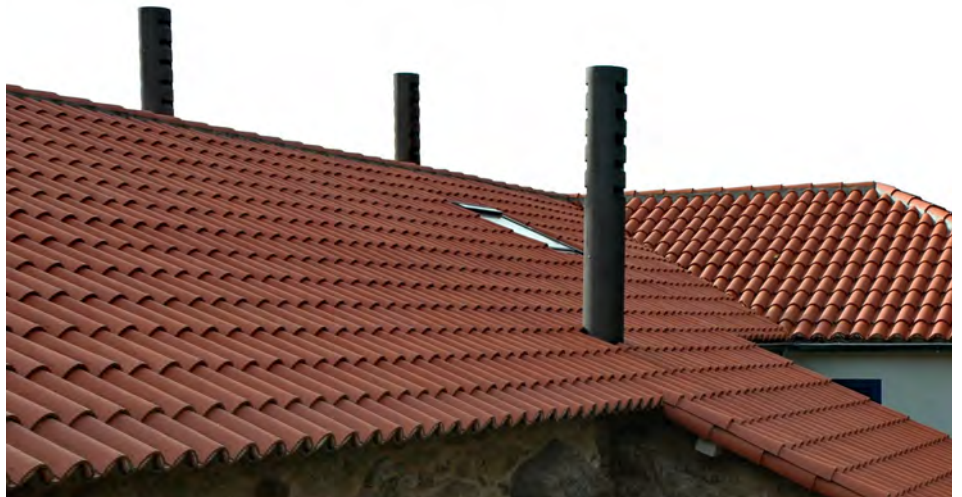
Chemineas prefabricadas de chapa de aceiro con acabado de pintura férrica na cuberta dunha vivenda rehabilitada
