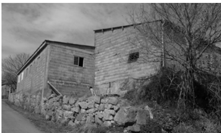
Construción de bloque de formigón cunha solución de baixa calidade, que en calquera caso non debería quedar á vista
