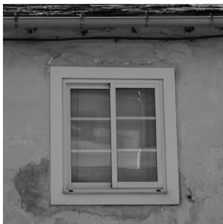
Substitución de ventá tradicional por carpintería de aluminio con perfís de plástico na cámara do vidro que imitan os maineis de madeira
