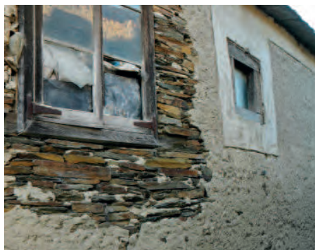
Revestimento dun muro de lousa con morteiro de barro parcialmente perdido, o cerco da ventá e a parte inferior do beirado presentan un remate de morteiro de cal. Santiago de Renche, Samos
