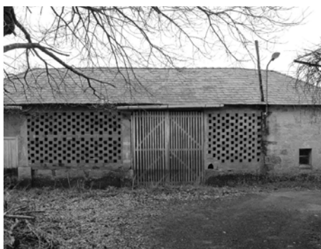
Substitución das partes de madeira do cerramento dunha palleira por peches de fábrica de ladrillo
