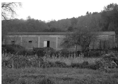
Nave de estrutura de formigón con cerramento de bloque e cuberta de fibrocemento. A falta de calidade construtiva das fachadas aconsella o seu revestimento
