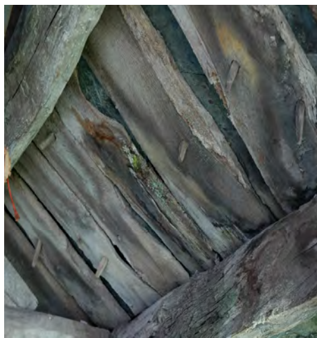
Vista da parte inferior dunha cuberta de xisto. Na imaxe aprécianse os tornos utilizados para fixar as lousas ás latas que forman o plano de sustentación da cuberta
