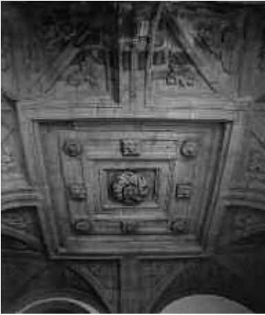
Fig. 13. Bóveda de la escalera de cámara de San Martín. Fr. Gabriel de Casas.
