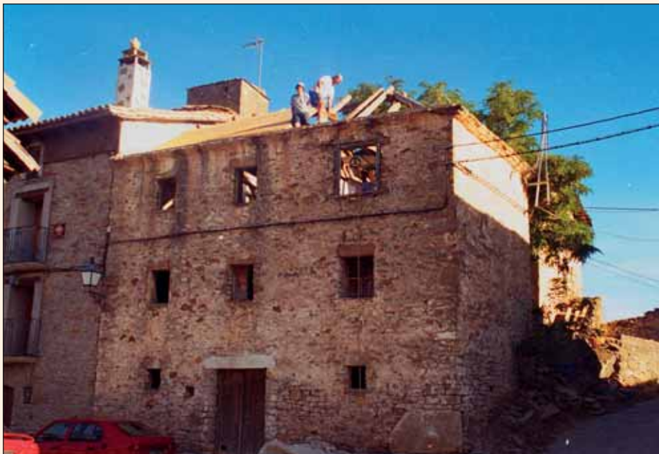
Obras de rehabilitación del albergue de Arrés (Huesca) en el año 2000, con hospitaleros-operarios también 'voluntarios'. Fernando Gimeno
