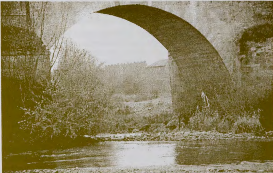
Antiguo puente sobre el Esla. En sus inmediaciones se encontraba ubicado el hospital de san Adrián.
