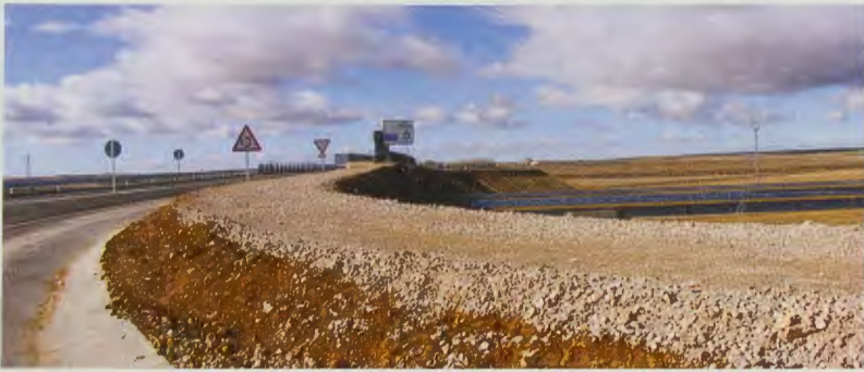
Detalle del camino peatonal de acceso al puente que cruza la A 67.
