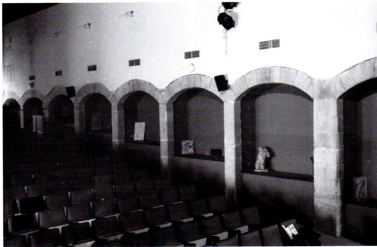
FIGURA 5. Muro lateral de la sala de hombres del hospital capitular de Plasencia.
