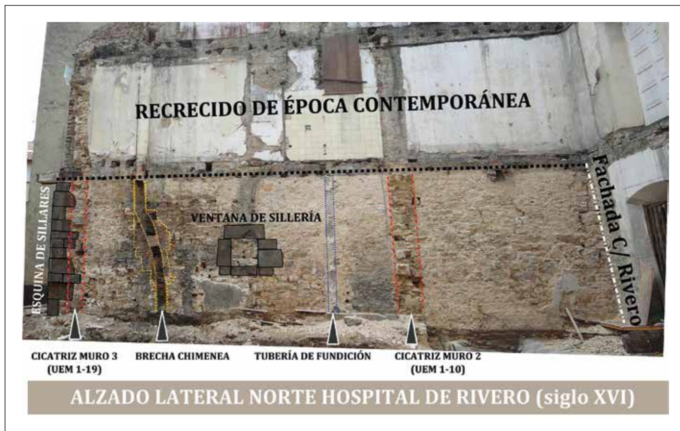
FIGURA II: Fotointerpretación del alzado identificado como perteneciente al antiguo hospital de peregrinos de Rivero.
