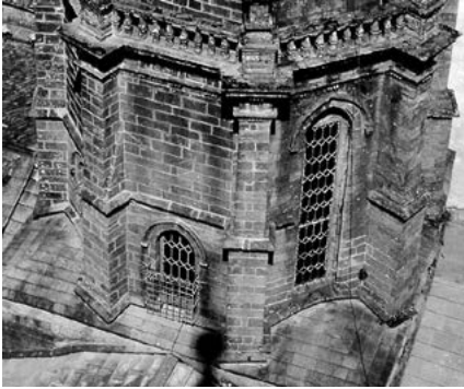
Fig. 4. Exterior del cimborrio de la catedral de Santiago antes de la restauración realizada entre 2016 y 2018. Esquinales reforzados y sus dos tipos de ventanas. (Archivo J. Ocaña).
