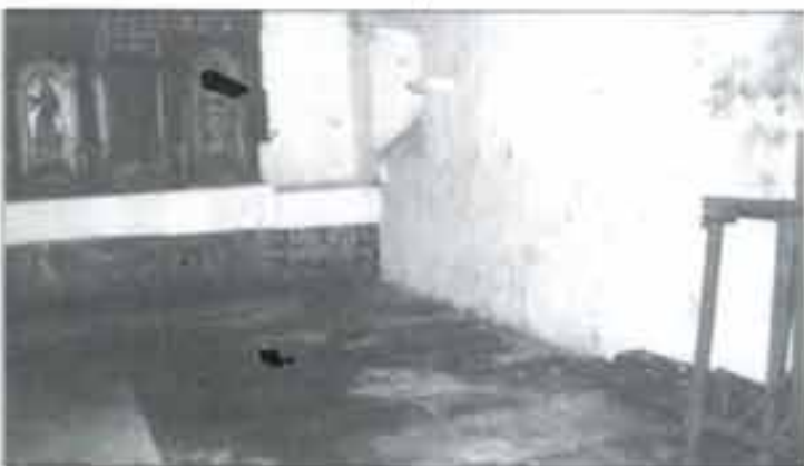
Lamentable estado actual del interior de la Ermita de San Roque.
